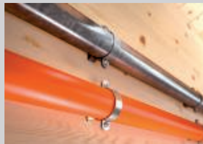
Kabelinstallatie met afzonderlijke klemmen en in buizen op de zijkant van houten balken.
