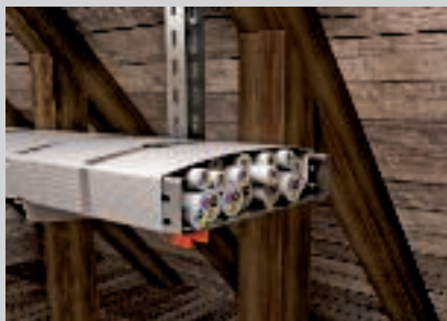
Kabeldraagsystemen met bandage in een omgeving met zeer veel brandbare materialen.
