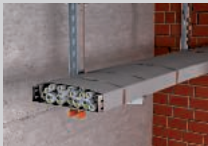
Complete omhulling van een opgehangen kabeltraject.
