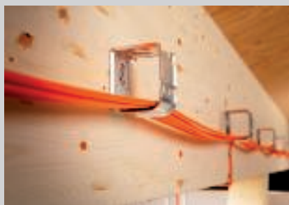
Kabelinstallatie met bundelhouder op de zijkant van houten balken.
