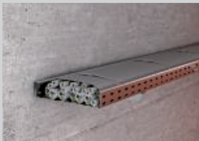
Complete omhulling van de kabels in een kabeltraject als wandmontage.
