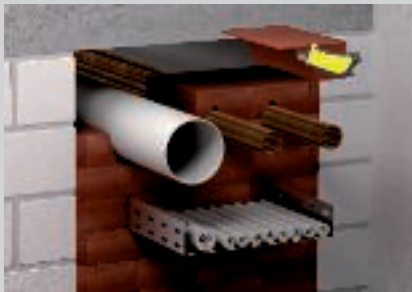
Doorvoer van brandbare buizen zonder aanvullende maatregelen.
