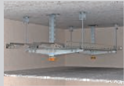
Tweelaagse plafondverlaging met aan beide zijden consoles.
