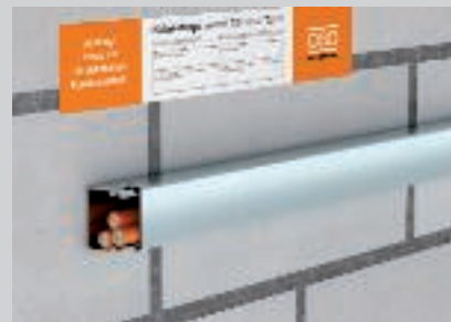
Goede installatie van data- en brandmeldkabels in het kanaal type 20030.
