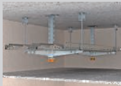
Tweelaagse plafondverlaging met aan beide zijden consoles.
