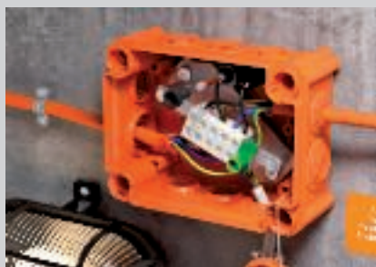
Kabelinvoer met schroefdraadnippels.
