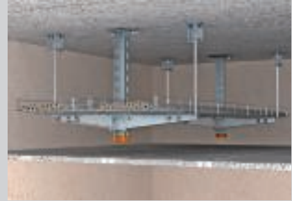
Tweelaagse plafondverlaging met aan beide zijden consoles.
