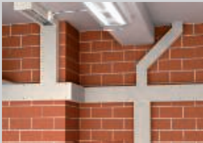
Gemonteerd brandwerend prefab kanaal aan de wand en plafond als I- en E-kanaal.
