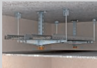
Tweelaagse plafondverlaging met aan beide zijden consoles.
