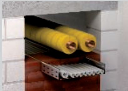
Doorgevoerde niet brandbare buizen met isolatie.
