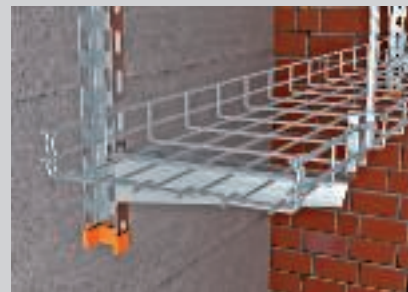
Schroefloze bevestiging van de draadgoot op de console.
