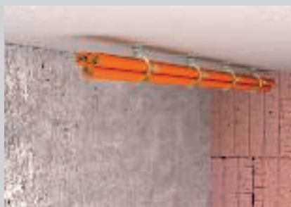
Gebundelde kabelinstallatie onder het plafond.
