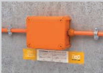
Geïnstalleerde FireBox met identificatieplaatje.
